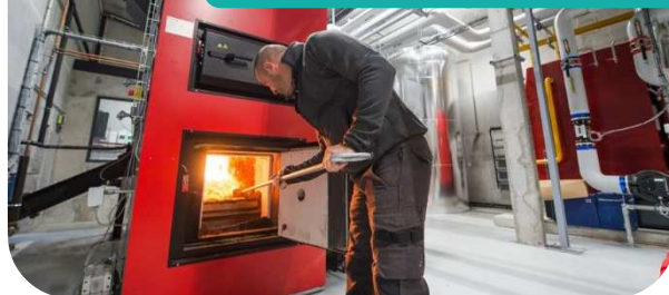
Chaufferie bois de la ville de Ploemeur
